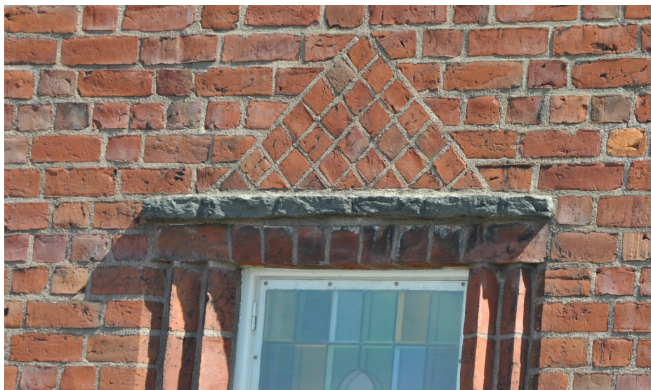
Figur 9:4. Masthuggskyrkan, Göteborg, 1914, arkitekt Sigfrid Ericson. Över öppningen har murats ett rakt valv med liggande kopp och flatsidor vid upplagen. Naturstenens höjd och fog har anpassats till övrig skiftgång.
