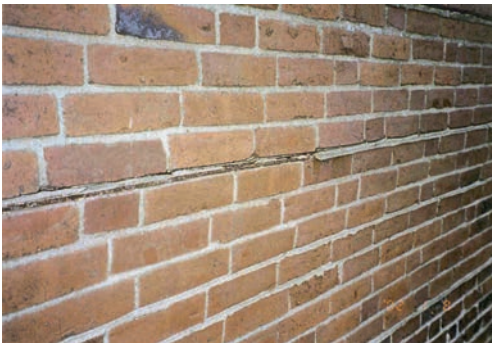
Bild 1.2. Fasaderna på Malmö Tekniska Museum, byggt 1972, uppvisar stora korrosionsskador. Fogbruk har här tryckts ut ur murverket.
