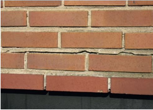
Bild 1.1. Tydlig horisontal spricka på grund av rostsprängning i murverk över fönster, studentbostadsområdet Vildanden i Lund, byggt 1966.
