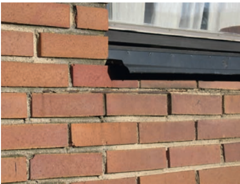
Bild 1.3. Rostsprängning i första skift under fönsteröppning, Vildanden, Lund.
